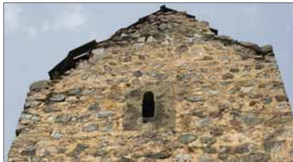
Следы перестроек над окном церкви (под двускатной крышей)
