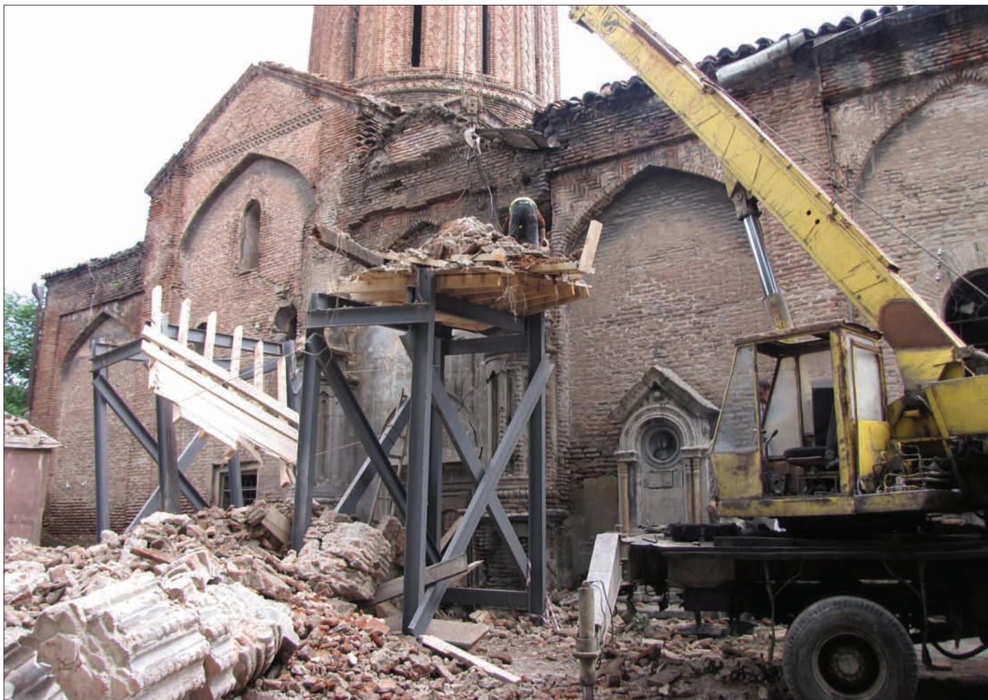
Обрушившийся ночью 14-го мая после проливных дождей портик перед северным входом церкви Сурб Ншан (фот. Н. Акопова, 14 мая 2012 г.)
