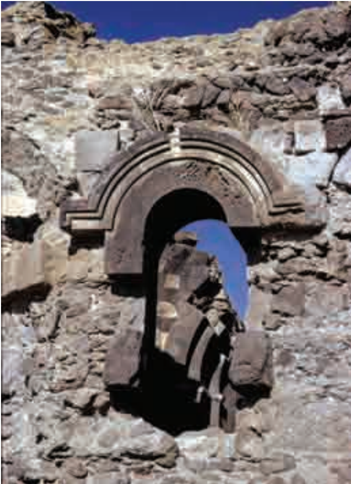
Արծվաբերի վանքն արևելքից և նույն ճակատից բացված լուսամուտն արտաքուստ 1974 (լուս.՝ ժ-Մ. Թիերրիի) և 2007 թթ. (լուս.՝ Ս. Կարապետյանի)
