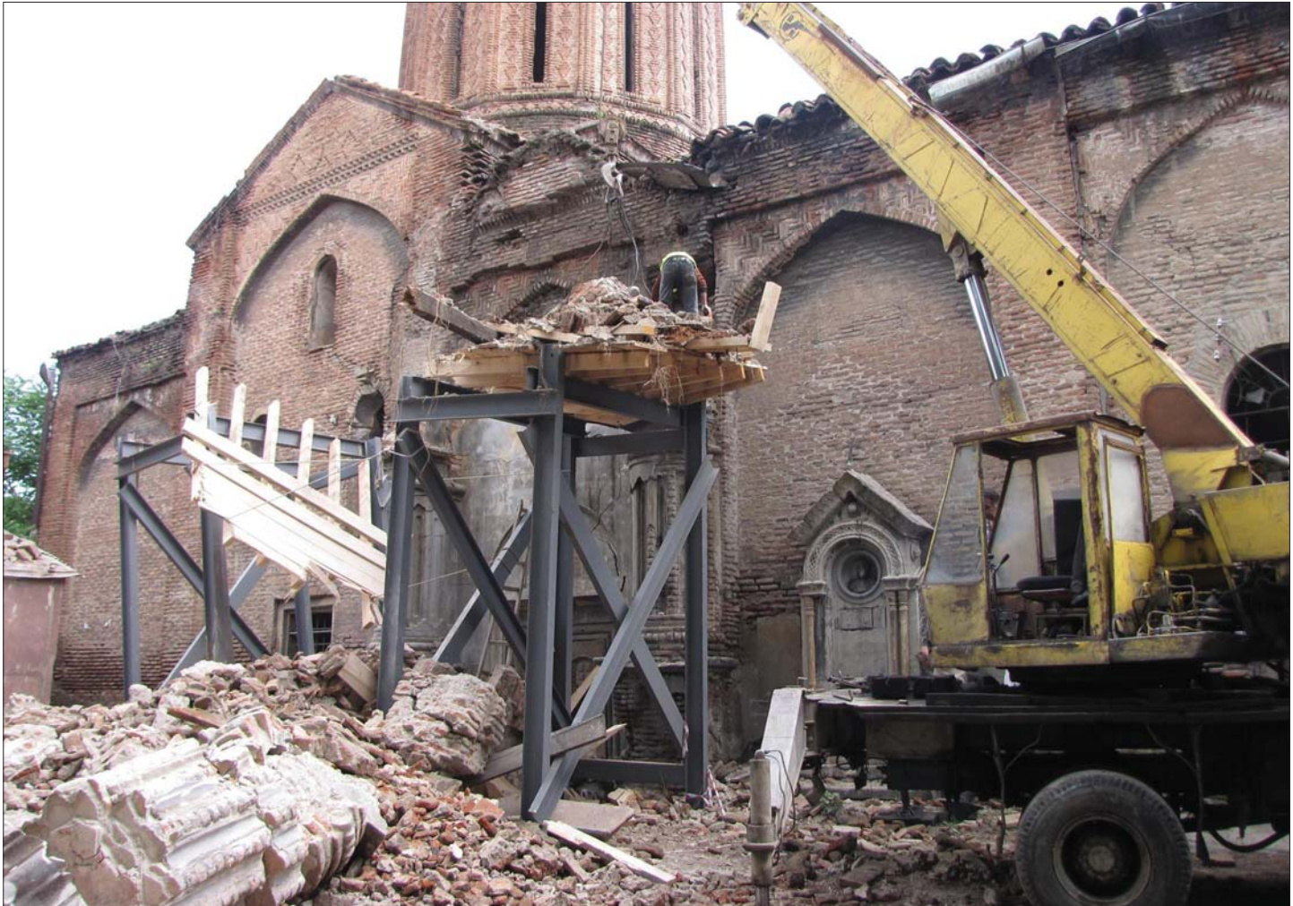
Սբ. Նշան եկեղեցու հյուսիսային մուտքի առջև կառուցված նախամուտքն իսպառ քանդված հորդ անձրևներից հետո՝ մայիսի 14-ի գիշերը (լուս.՝ Ն. Ակոպովի, 2012 թ., 14 մայիսի)
