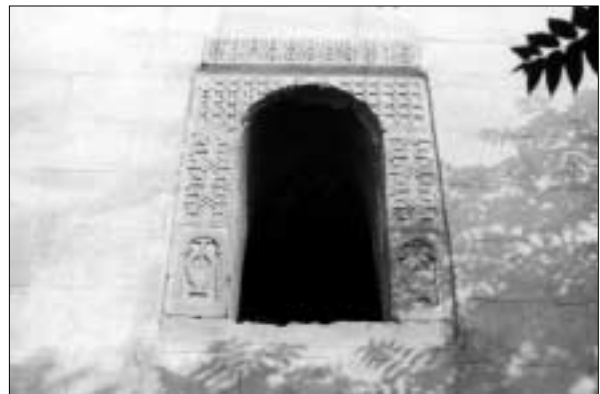
ԳԱՆՉԱԿ (ԳՅԱՆՁԱ). Սբ. Հովհաննես եկեղեցու հարավային ճակատից բացված մուտքը, մուտքի շինարարական արձանագրությունը և արևելյան ճակատից բացված լուսամուտը
