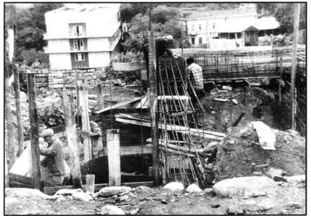
▼ 1997թ. հուլիսի 2-ին արդեն իսպառ ավերված Չորաբաշի Սր. Գևորգ եկեղեցու տեղում կատարվեց կառուցվելիք վրաց եկեղեցու հիմնօրհները: Հուլիսի 15-ի դրությամբ վրաց նոր եկեղեցու շինարարական աշխատանքները բուռն ընթացքի մեջ էին
